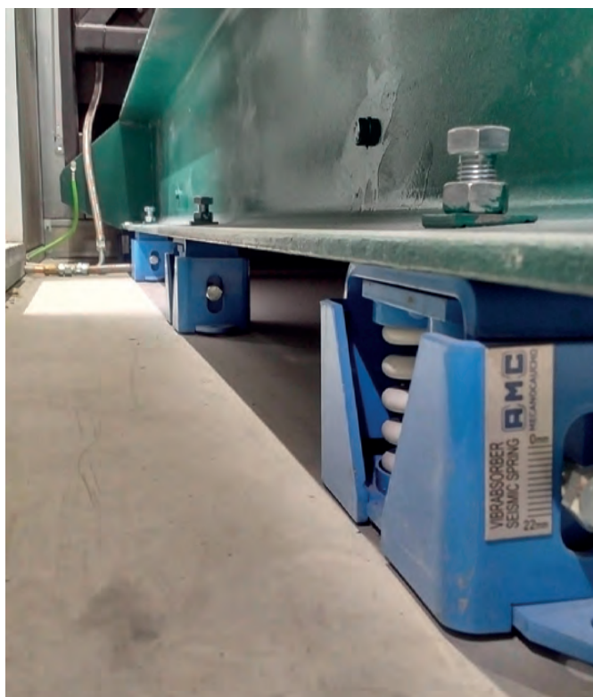
Compresor aislado con VIBRABSORBER+Sylomer ®
