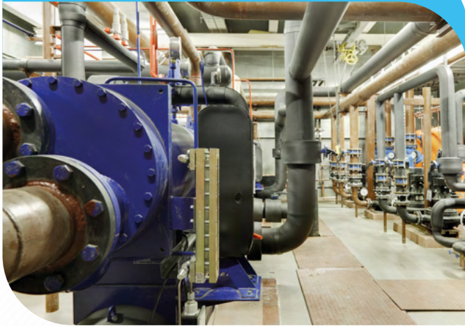
SALA DE MÁQUINAS
